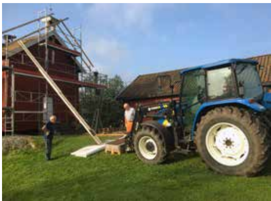
Her er taksteinene på vei ned. Sverre Sjøe og Jan Vidar Bjune tar imot og stabler i pallekasser. Foto: Kåre Holtung.
